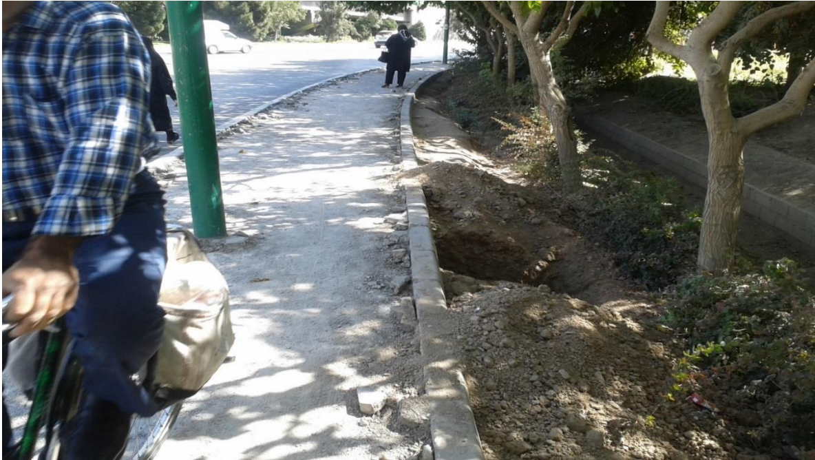
حفر گود برای پایه بدون حصار نمودن آن و عدم نصب علائم هشدار دهنده
