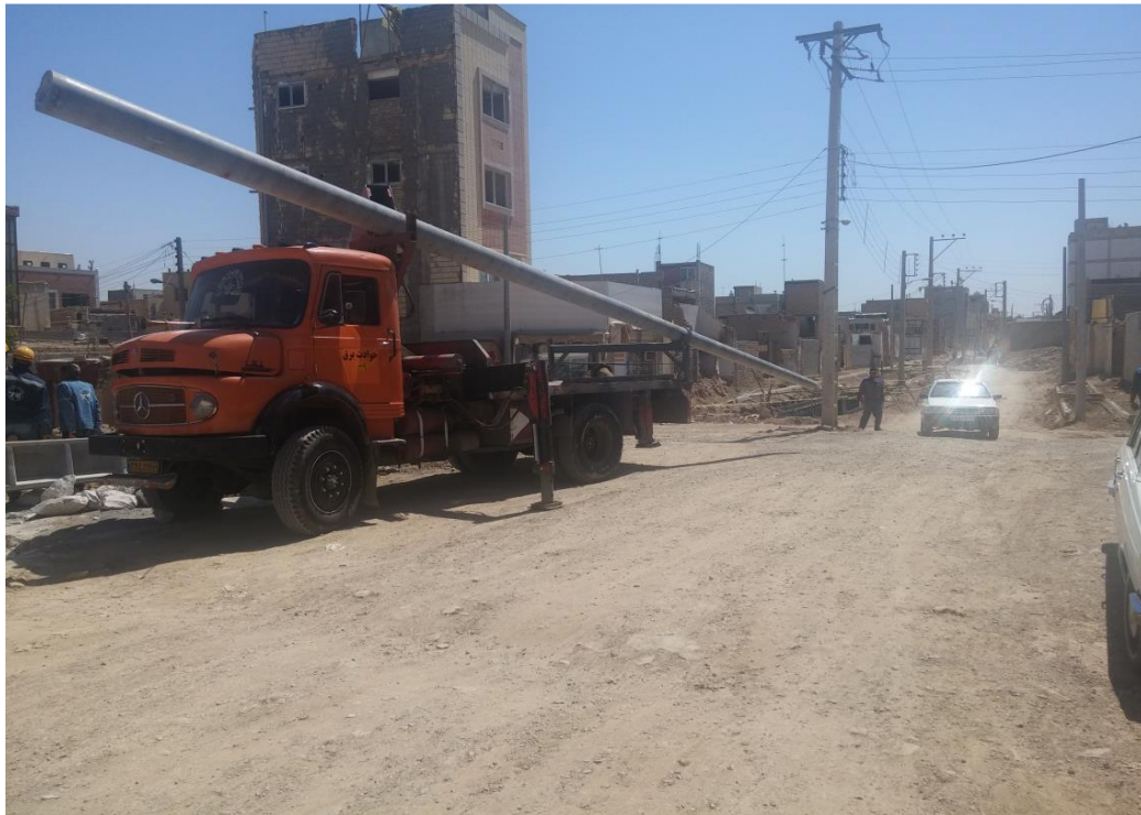
عدم استفاده از کله قند در محیط کارگاهی و حمل برعکس پایه
