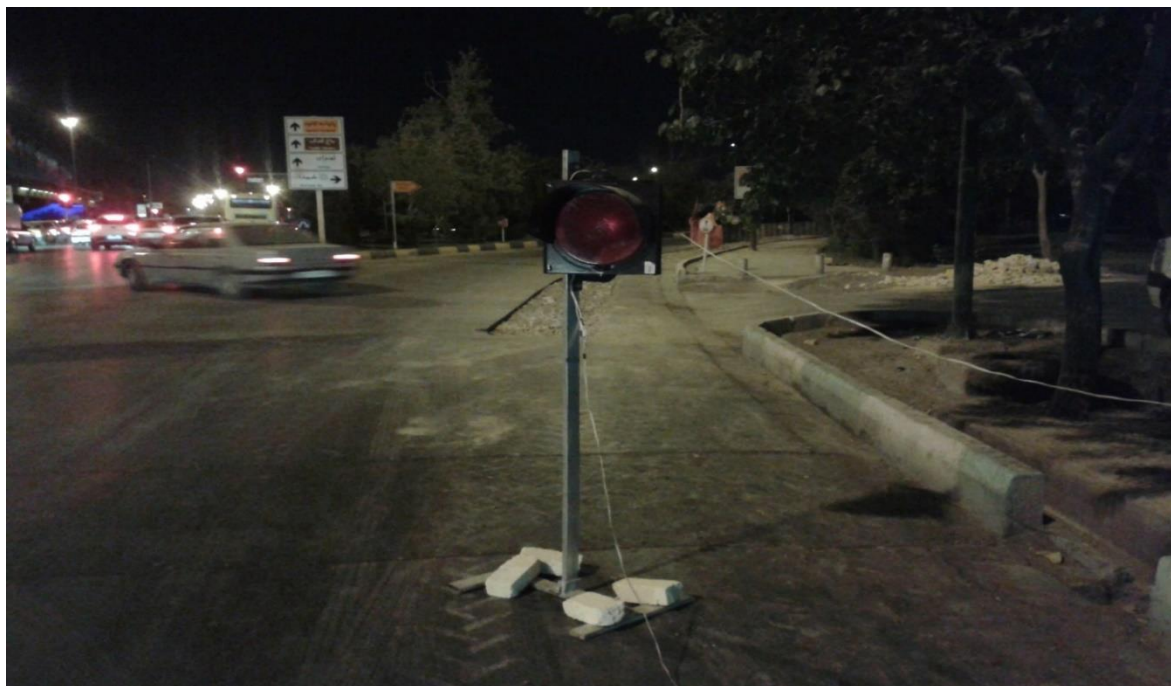
خاموش بودن چراغ در شب و عدم نصب علائم هشدار دهنده
