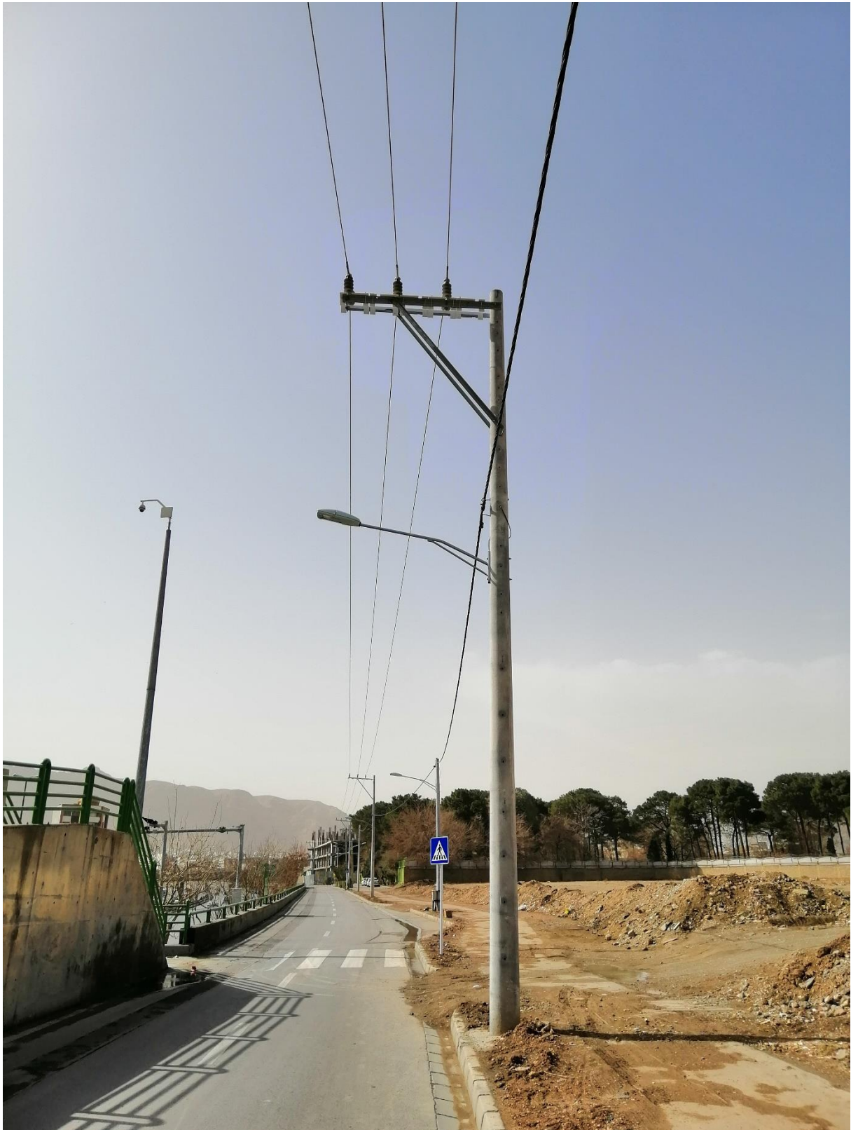
شبکه فشار متوسط هوایی به همراه کابل خودنگهدار فشار ضعیف روشنایی معابر
