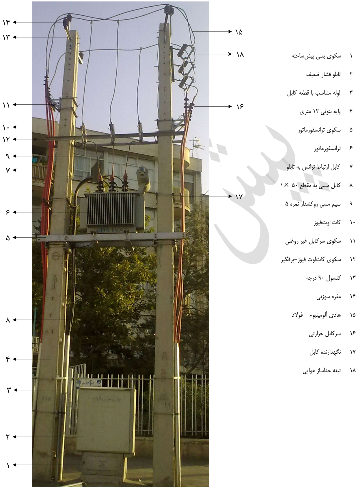
شکل (۳): پست هوایی نصب شده بر روی شبکه فشار متوسط زمینی
